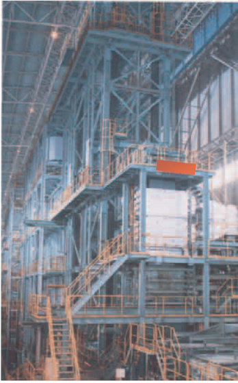
写真1 連続焼鈍ラインに設置されたWQ設備 1)
