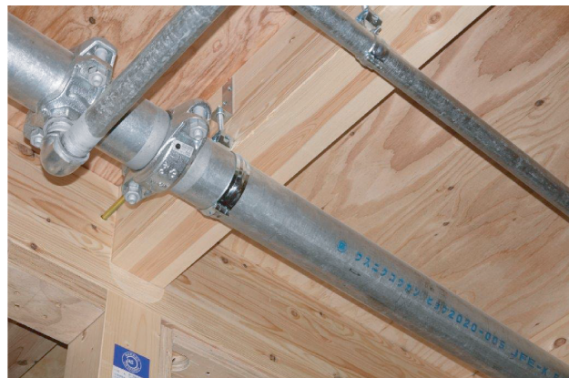
写真2 採用事例（老人ホーム スプリンクラー配管）
