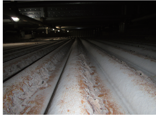
写真2 放射伝熱室状況 (SCS 適用後)
