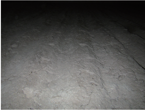
写真1 放射伝熱室状況 (SCS 適用前)
