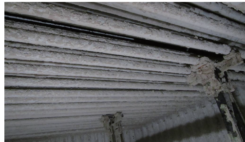
写真4 過熱器状況 (SPS 適用後)
