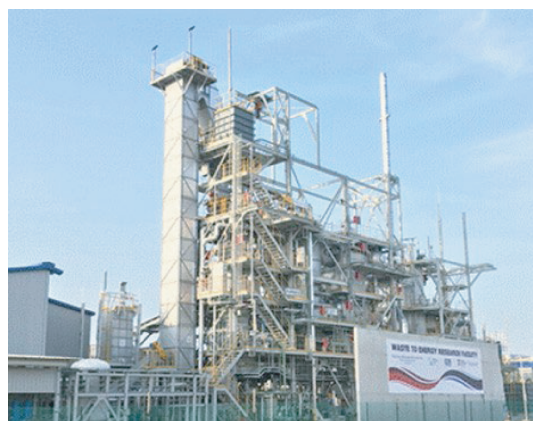
写真 2 高温ガス化直接溶融炉実証設備
