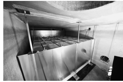
写真1 蓄熱槽内状況
