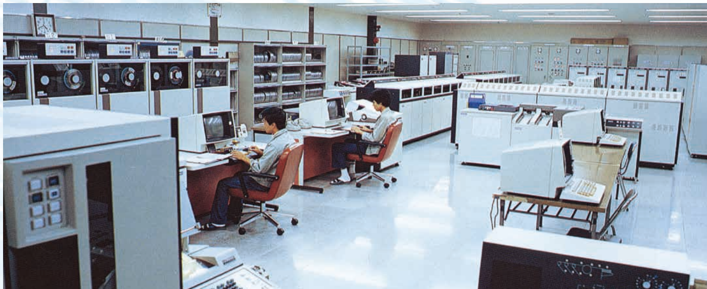
■セントラルコンピュータ室
