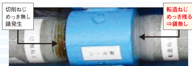
PFP-PB 模擬配管の暴露試験結果 (暴露場所：沖縄県浦添市／暴露期間：約1年)
