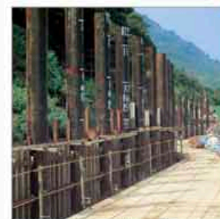
地すべり抑止杭
