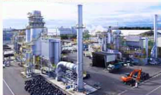
ストーカ炉（処理能力：110t/日×1炉） ロータリーキルン炉（処理能力：210t/日×1炉）
