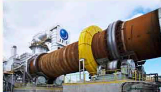
ロータリーキルン炉（処理能力：300t/日×2炉）
