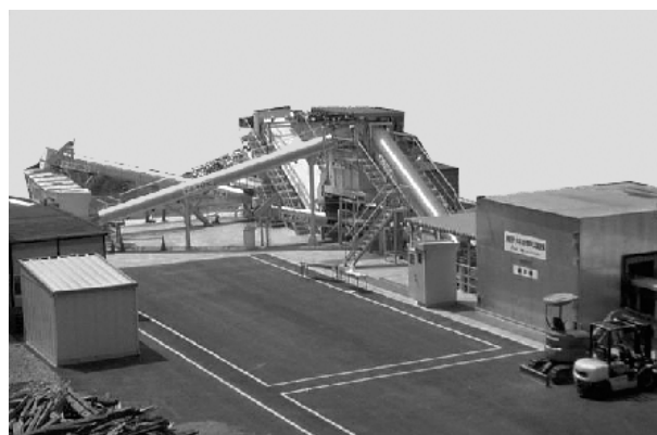
写真1 木屑の高炉原料化設備
