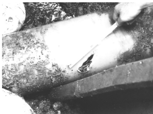
写真2 塗覆装損傷例 (損傷寸法 1×2cm=2cm 2 )
