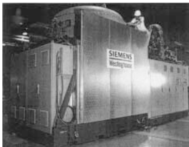
写真2 20kW SOFC ハイブリッドシステム
