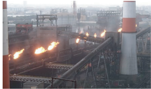
写真 1 実機稼働状況
