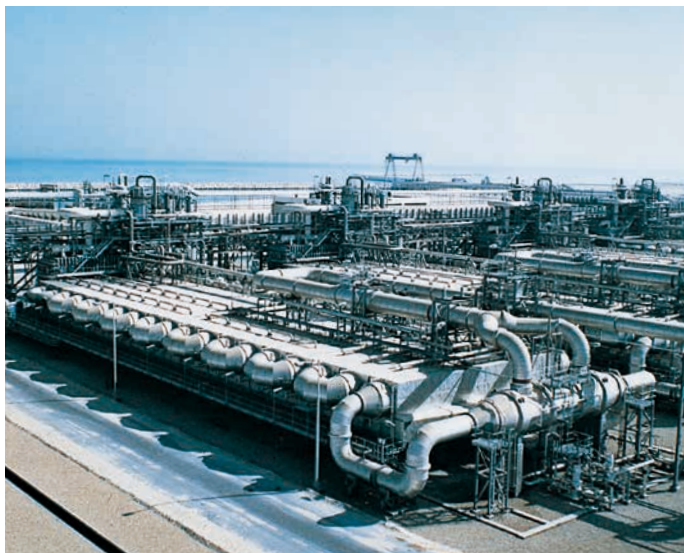
海水淡水化プラント/Seawater desalination plants
