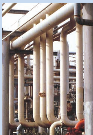
▲プラント配管
