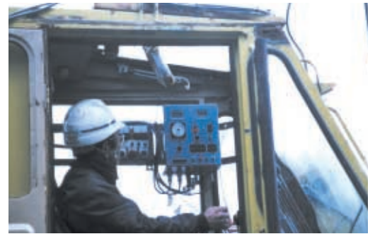
施工管理計の例
