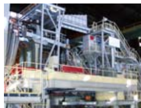
取鍋精錬設備
