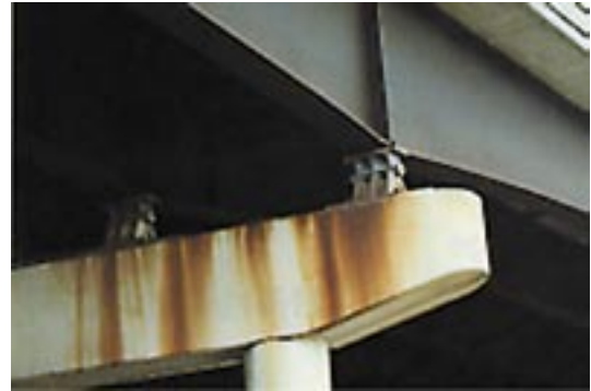
参考 流れさびによるコンクリート橋脚の汚染
