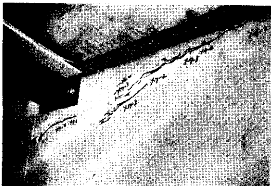
写真 6 耐火パネルの亀裂 (変位 4.21mm)
